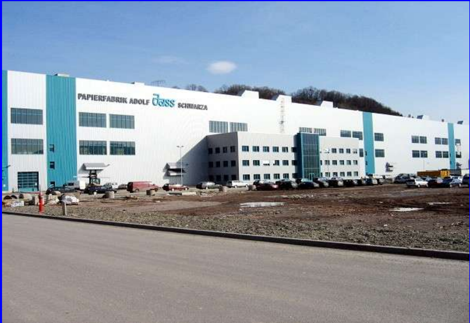
Großbaustelle mit Flächenrecycling / Rudolstadt-Schwarza 2. Symposium Umweltgeotechnik der DGGT E.V. TU Bergakademie Freiberg / Sachsen
